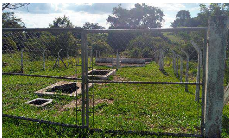
Figura 173 - ETE Fossa Filtro Morada Verde - Vista geral.
