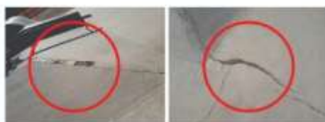
Piso com rachaduras
